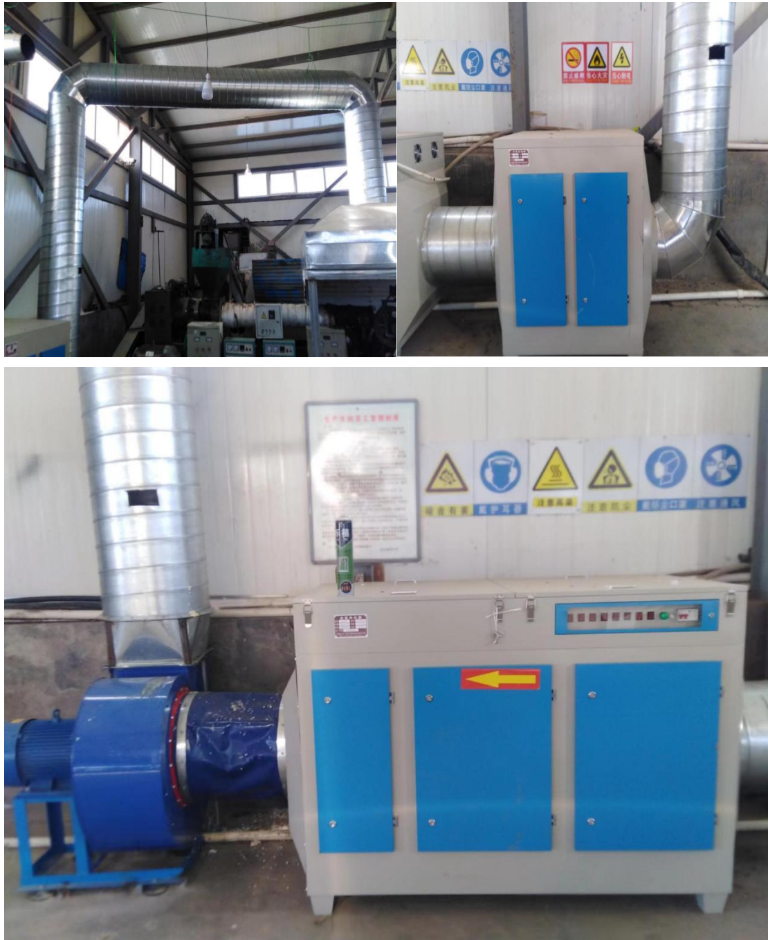
图 3-3 废气治理设施及排气筒
